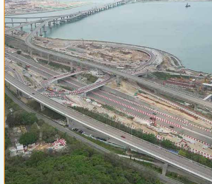
北大嶼山公路旁的道路及渠務建造工程 Road and drainage works adjacent to North Lantau Highway
